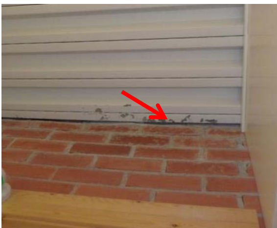
Kuva 19. Teknisen työn luokan kohdalla välipohjan alapinnassa on kosteusjälkiä.
