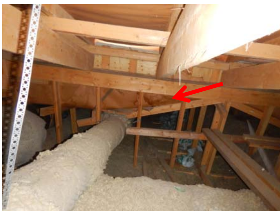
Kuva 79. Vesikaton rakenteissa ja aluskatteessa on vuotojälkiä.
