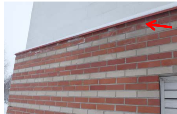
Kuva 52. Seinän alaosaa on tiiliverhoiltu. Verhouksen yläosassa on kosteusjälkiä.
