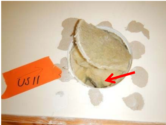
Kuva 47. Luokan 143 ikkunan yläpuolinen rakenneavaus. Seinässä ei ole höyrynsulkumuovia.
