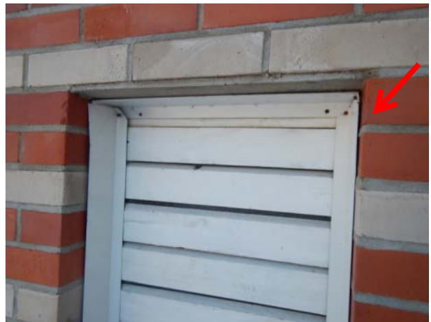
Kuva 62. Luukun pellitys ja rakenne ei ole tiivis.
