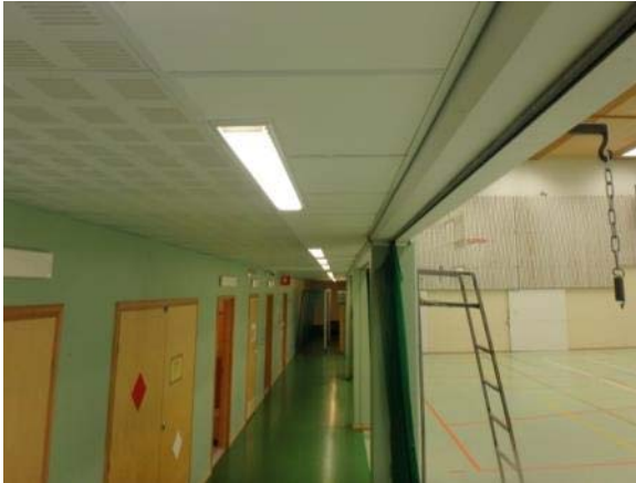
Kuva 25. Juoksuradan kohdalla alaslasketun katon yläpuolella on muottilautoja ja mineraalivillaa.
