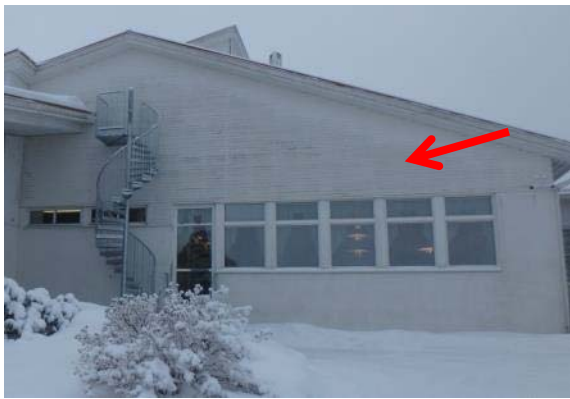
Kuva 55. Puuverhous on paikoin huonokuntoinen ruokalan päädyssä.
