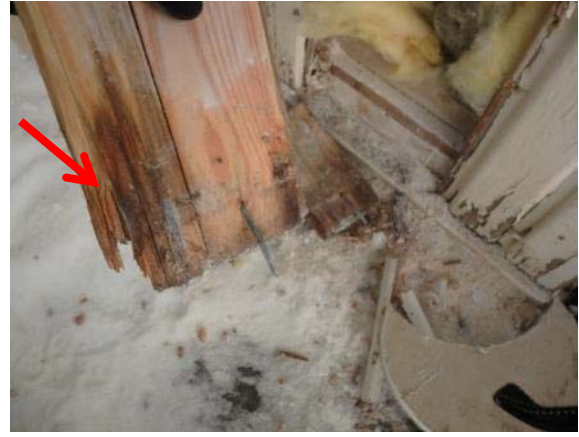
Kuva 42. Puuverhouksen alaosaan on lahovaurioita.
