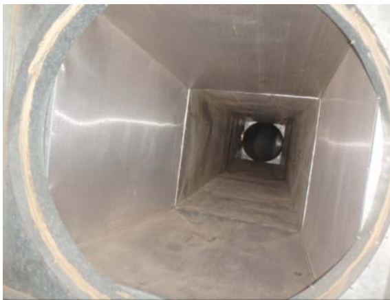
Kuva 89. Ilmavaihtokanavat ovat likaisia.
