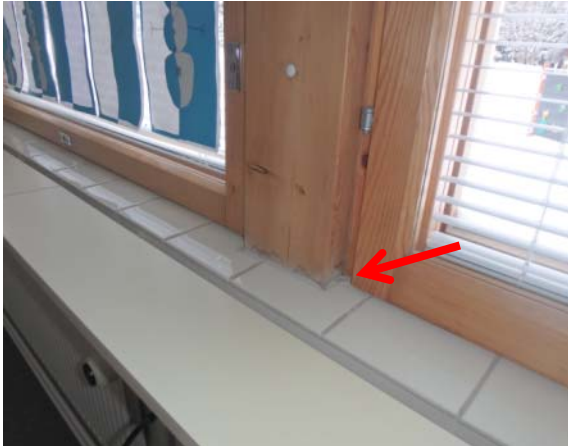
Kuva 59. Ikkunaväleissä on paikoin kosteusjälkiä.
