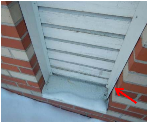
Kuva 61. Luukun pellitys ei ole tiivis.
