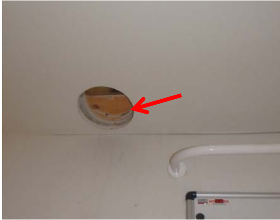
Kuva 75. Rakenneavaus ruokalan vuotojäljen kohdalle.
