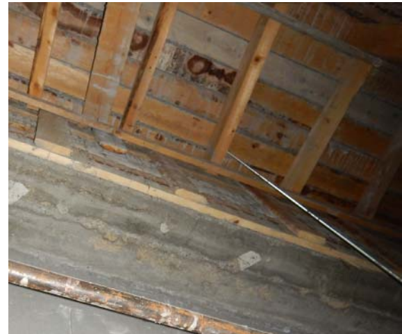
Kuva 24. Auditorion parven alapuolelle on jätetty vanhoja muottilautoja.
