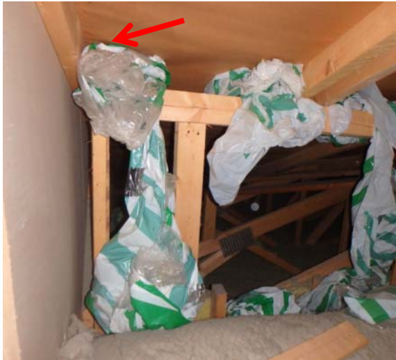
Kuva 77. Ruokalan kohdan vuotokohta yläpohjasta.
