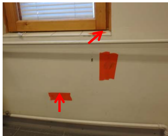
Kuva 64. Ulkoseinästä on runsaasti ilmavuotokohtia.
