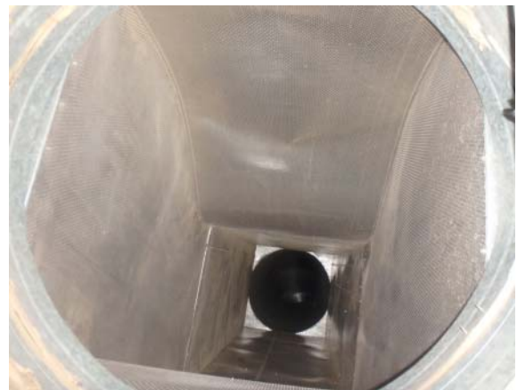
Kuva 90. Ilmavaihtokanavat ovat likaisia.
