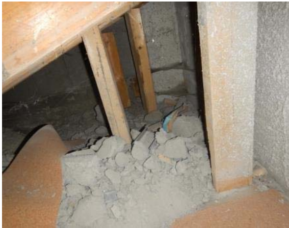
Kuva 81. Auditorion portaan alapuolella tuolivarastossa on vanhoja muottilauoituksia ja rakennusjätettä, rakenneavaus PRS2.
