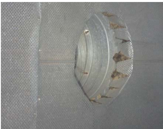
Kuva 87. Tuloilmakammiossa on paljaita mineraalivillaeristeitä.
