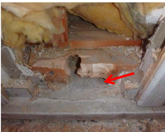
Kuva 45. Alajuoksun ja sokkelin välissä ei ole kosteuskatkoa.
