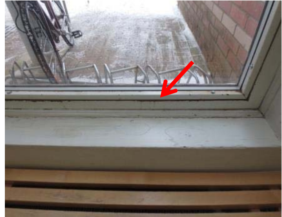
Kuva 60. Ikkunassa on ruostetta ja ikkunapenkillä kosteusjälkiä.
