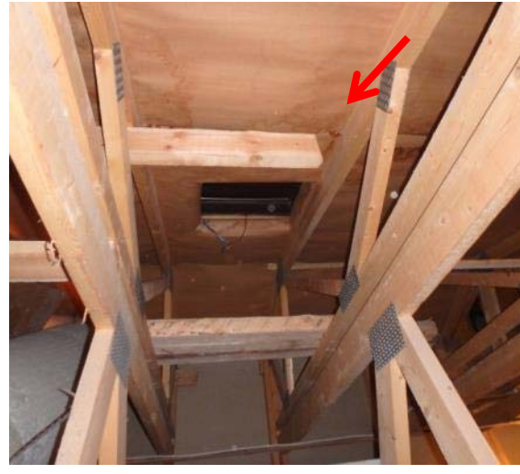
Kuva 78. Vesikaton rakenteissa ja aluskatteessa on vuotojälkiä.
