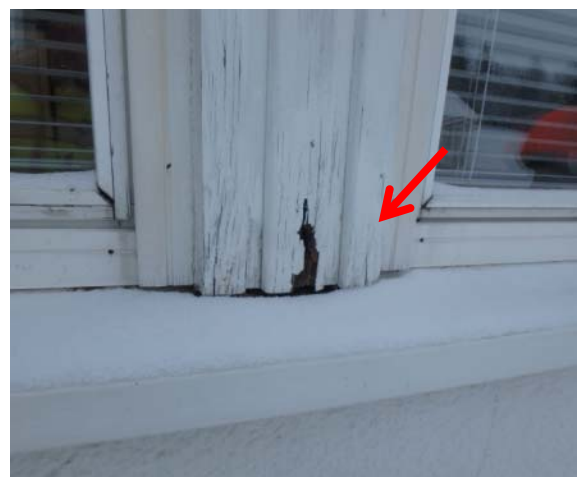
Kuva 58. Luukkasiiven ikkunavälien puuverhouksessa on lahovaurioita.
