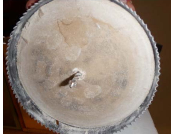
Kuva 76. Kipsilevyssä on kosteusjälkiä ja mustaa kasvustoa.
