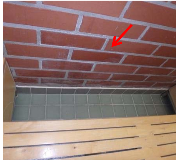
Kuva 66. Siivouskeskuksen kosteusvaurio on kastellut siivouskeskuksen ja pukuhuoneen välisen seinän.
