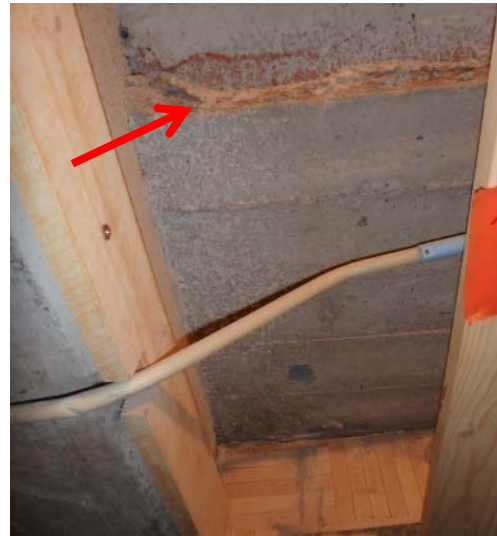
Kuva 38. Maanvastaisen seinärakenteen avaus MV6. Seinä on kostea, alimman tiilirivin kohdalla tasoitteet on irtoillut.
